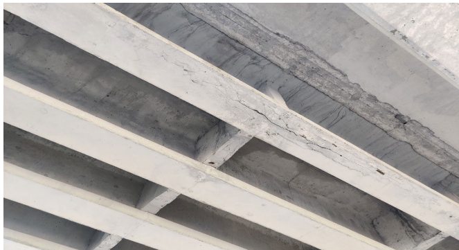
Рисунок 1 — Корозійна тріщина в захисному шарі бетону балки
