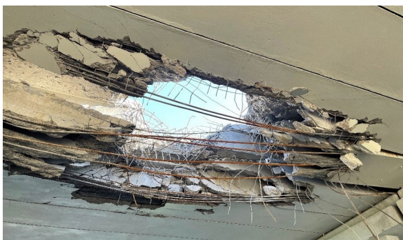
Рисунок 2 — Руйнування плит прогонової будови виконаних за типовим проектом ВТП-21 внаслідок влучання ракети ворожої авіації
