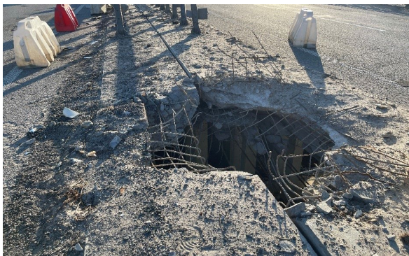
Рисунок 3 — Руйнування елементів мостового полотна
