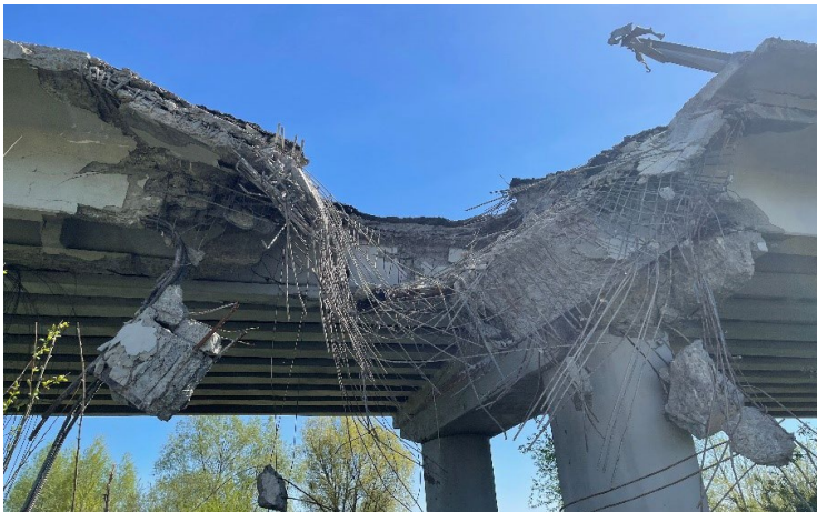
Рисунок 4 — Пошкодження балок прогонових будов споруди
