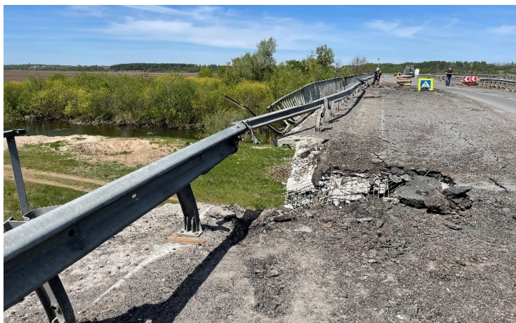
Рисунок 5 — Руйнування елементів мостового полотна та прогонової будови споруди
