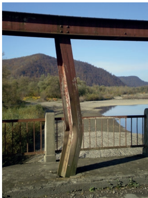
Рисунок 6 — Погнута стійка прогонової будови. Знижена несна здатність прогонової будови (міст на автомобільній дорозі територіального значення Т-07-37 Хуст – Шаян – Вишково – Буштино з під’їздом до санаторію «Шаян» на км 1+248)
