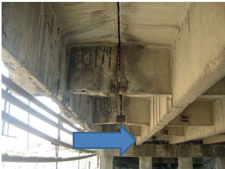
Рисунок 5 — Одна з балок прогонової будови не опирається на ригель, а «висить» на сусідніх балках та виключена з роботи (міст через Великий Аджаликський лиман на автомобільній дорозі міжнародного значення М-28 Одеса – Южний — /М-14/ на км 22+856)
