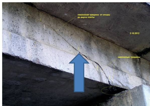
Рисунок 3 — Похила тріщина в приопорній зоні (міст на автомобільній дорозі Р-46 Харків – Охтирка на км 80+419)
