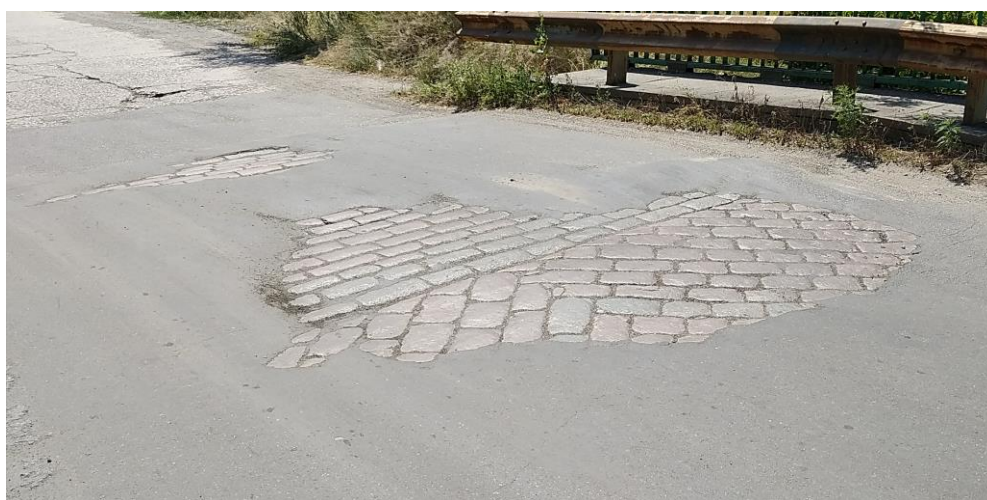
Рисунок 2 — Вид на стару гранітну бруківку, яка відкривається через зруйновані ділянки асфальтобетонного покриття на проїзній частині
