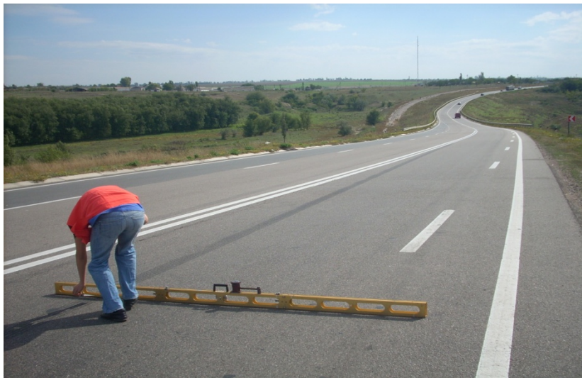
Рис. 5. Стан ділянки автомобільної дороги Ульянівка-Миколаїв у вересні 2009 року
