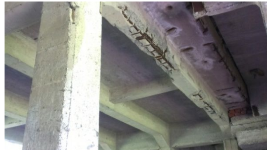
Рисунок 6 – Корозія бетону плити і ребра
