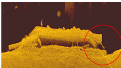
Рисунок 3 — Зафіксований локальний розмив підводної частини опори
