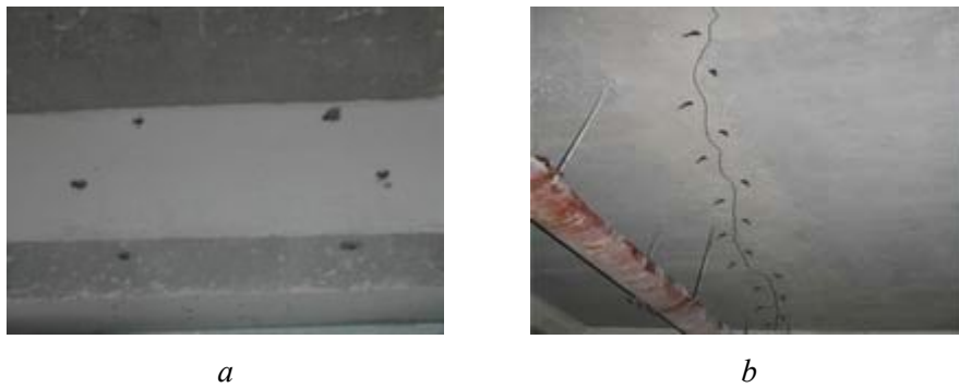
Рис. 3. Тріщини в монолітних залізобетонних балках та плитах перекриття та покриття і порядок склеювання тріщин
