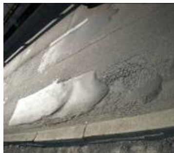
Рис. 2. Автодорожній міст метро через Дніпро, обстеження 2010 р.
